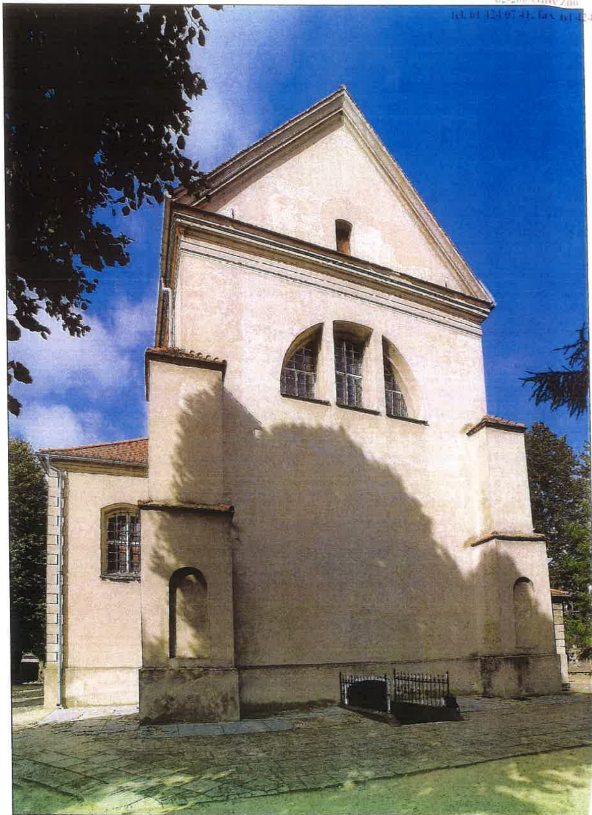
Fot. 5. Widok ogólny elewacji wschodniej. Na fotografii dobrze widoczne „urobki” tynkarskie wykonywane w ramce drewnianej.
