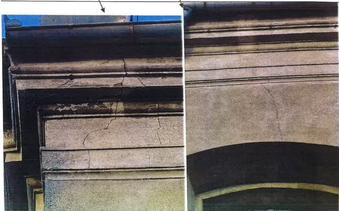
Il. 9 - 11. Elewacja południowa. Na wszystkich elewacjach widoczne rozległe pęknięcia statyczne. Pęknięcia nadproży (u dołu po prawej) przechodzą niemal przez całą grubość muru. Szrafem zaznaczono uszkodzone tynki (zidentyfikowane z poziomu otoczenia kościoła, oględziny z rusztowań mogą znacznie rozszerzyć zakres).
