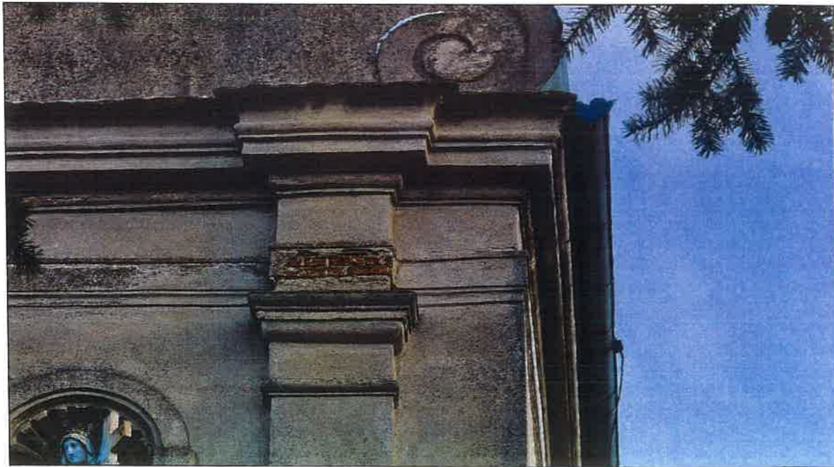
Il. 14. i 15. Elewacja zachodnia. Widoczne pęknięcia muru i uszkodzenia tynku.
