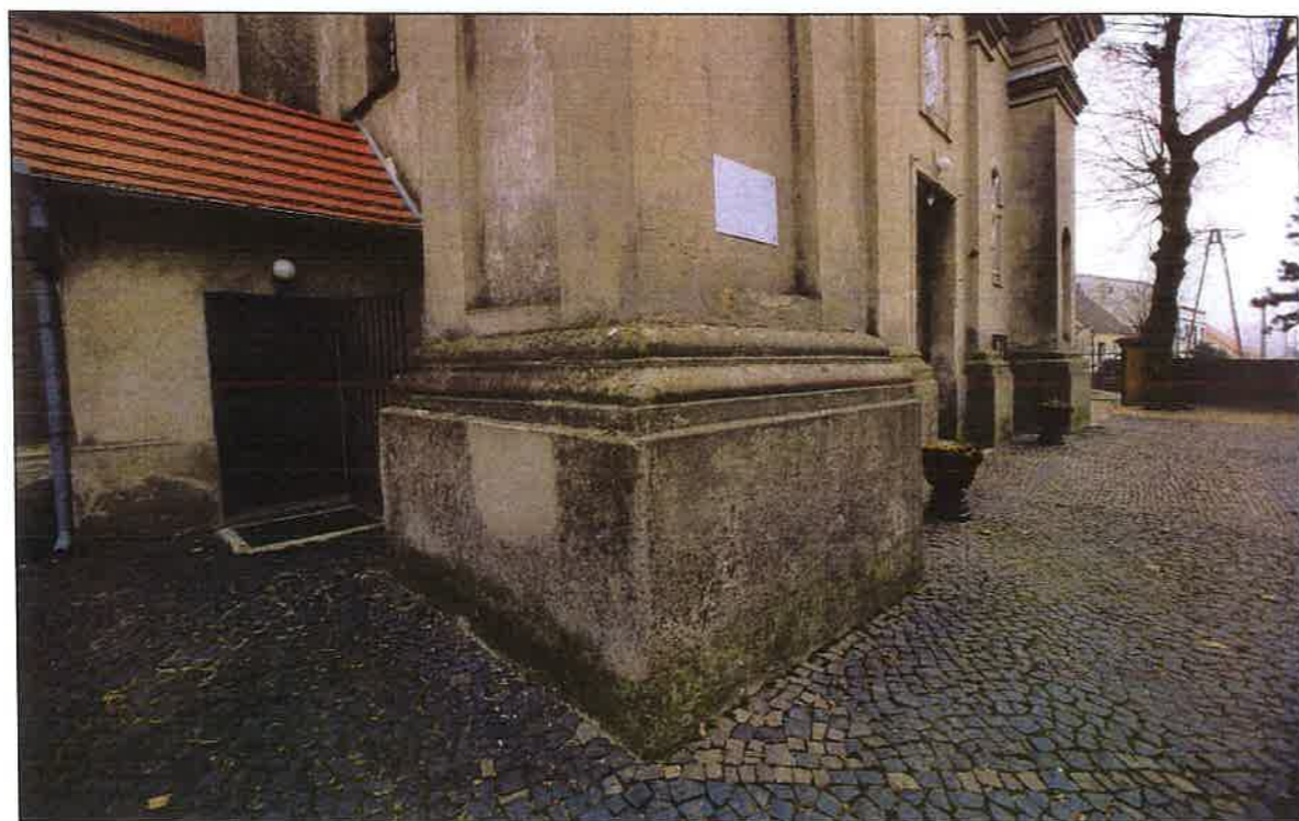
Il. 2. i 3. Tynki partii cokołowej w widoczny sposób wykonane mocnymi zaprawami cementowymi – prawdopodobnie na skutek działania wilgoci partie te uległy szybkiemu zniszczeniu. Dobrze widoczne kolonie porostów i lokalne wysolenia.
